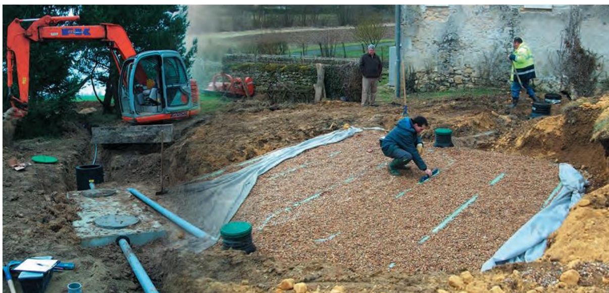
Fosse toutes eaux et filtre à sable
