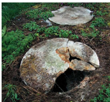
Couvercle de fosse toutes eaux corrodé
