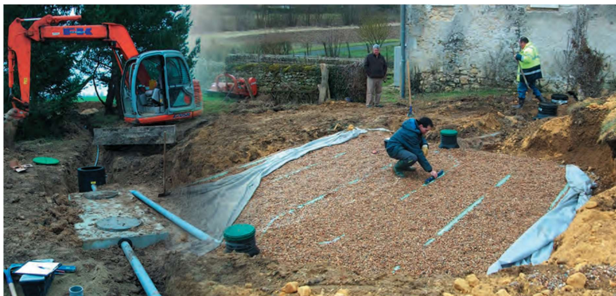
Fosse toutes eaux et filtre à sable
